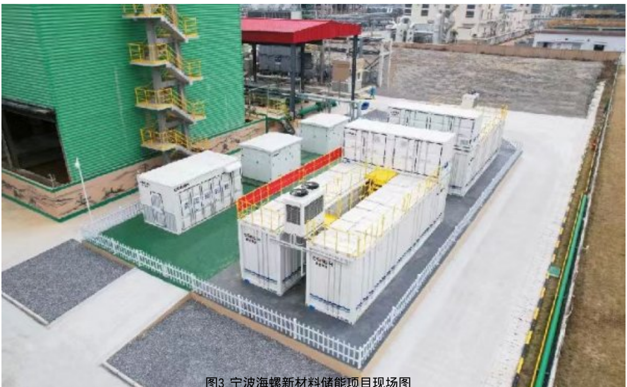
图2 枞阳海螺储能项目现场图
